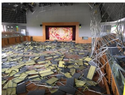
天井が落下した益城町総合体育館
