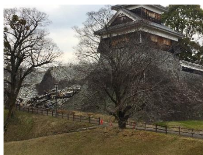
崩落した熊本城の石垣
